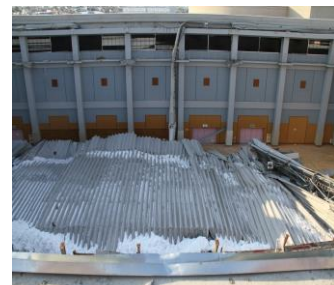
体育館の屋根崩落被害(埼玉県)
